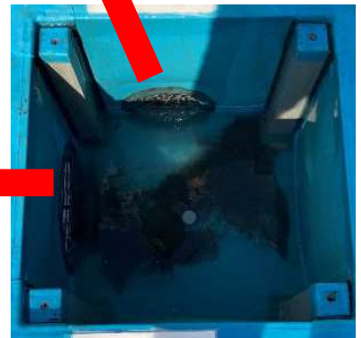
大プール排水口
